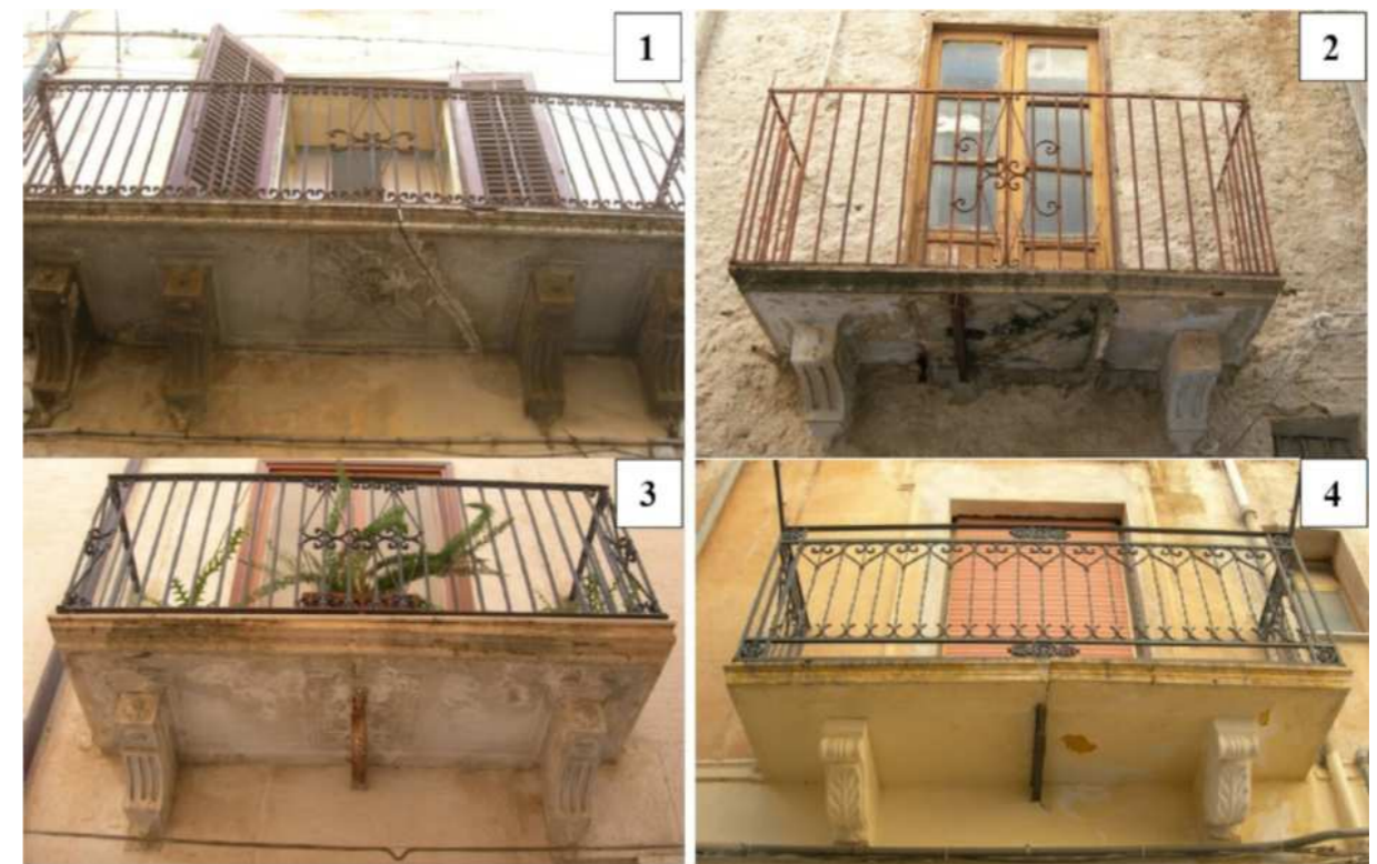
Fig. 4 - Viste dei balconi lesionati oggetto di studio.
