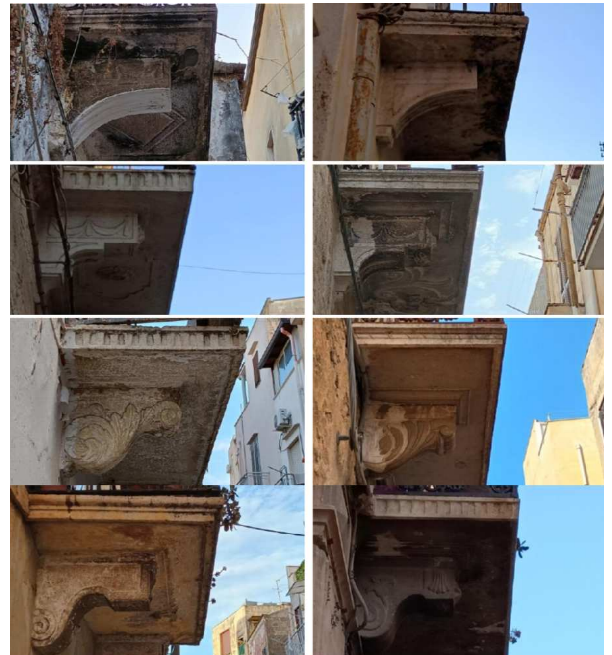
Fig. 2 - Viste laterali delle mensole dei balconi.
