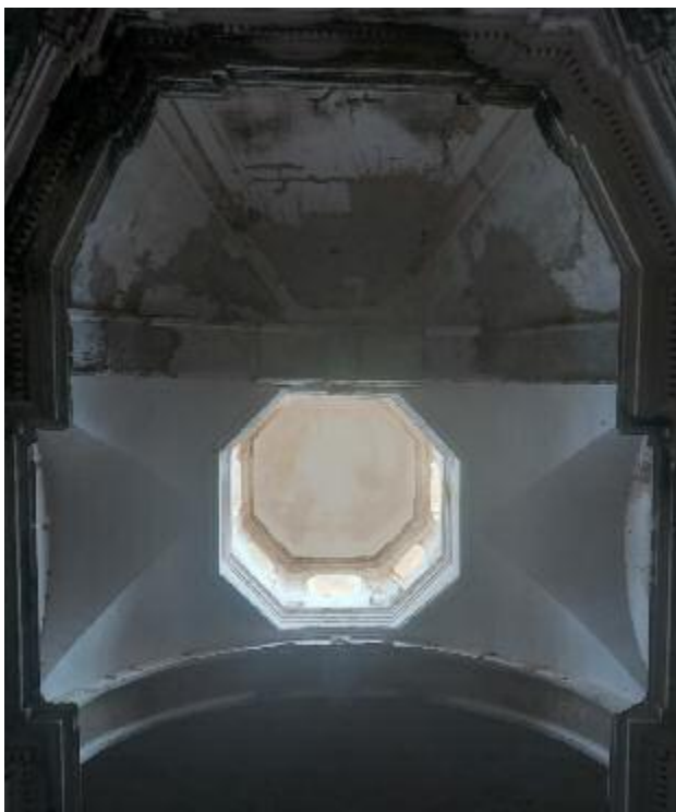
Fig. 32. Marsala. Chiesa di Santa Maria della Grotta, veduta interna verso la copertura del presbiterio (foto di M. Cannella).
