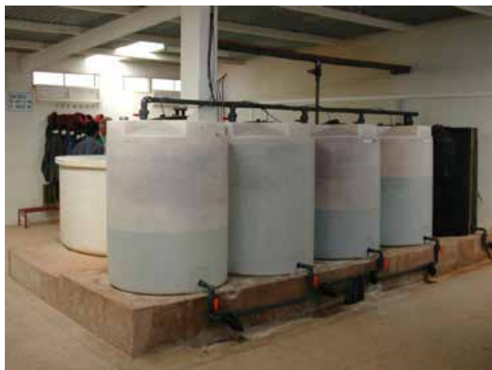
Recente installazione di un impianto di fertirrigazione
