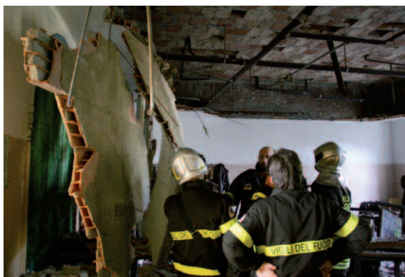
Fig. 5: Liceo Darwin, Torino. Crollo del controsoffitto a seguito del quale ha perso la vita uno studente di diciassette anni (dal sito www.ilgiornale.it ; 24 novembre 2008).
