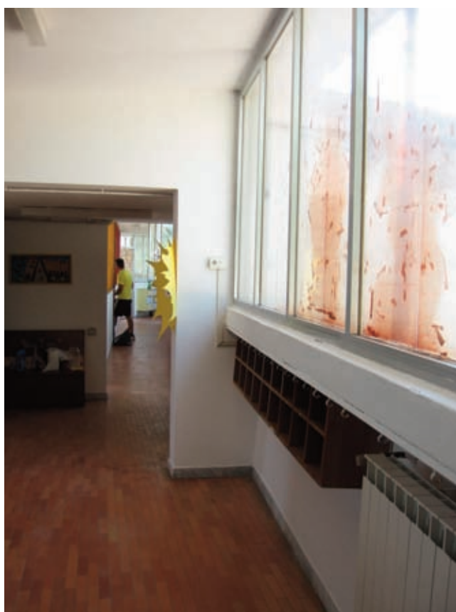
Figura 72: Scuola Materna - l'infisso esterno del corridoio.
