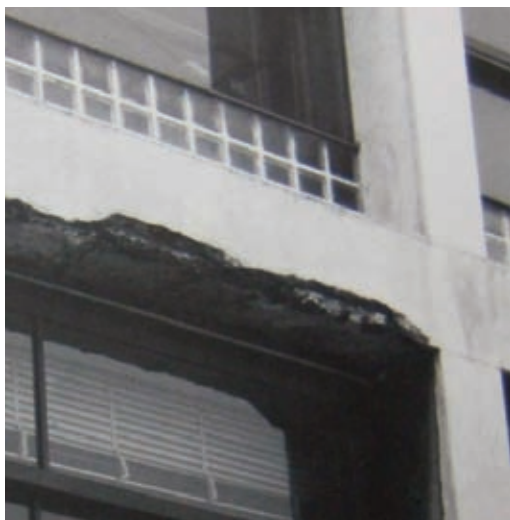
Figura 13: Il fronte principale con i degradi del marmo (Archivio Municipale di Como, Casa del Fascio di Como).
