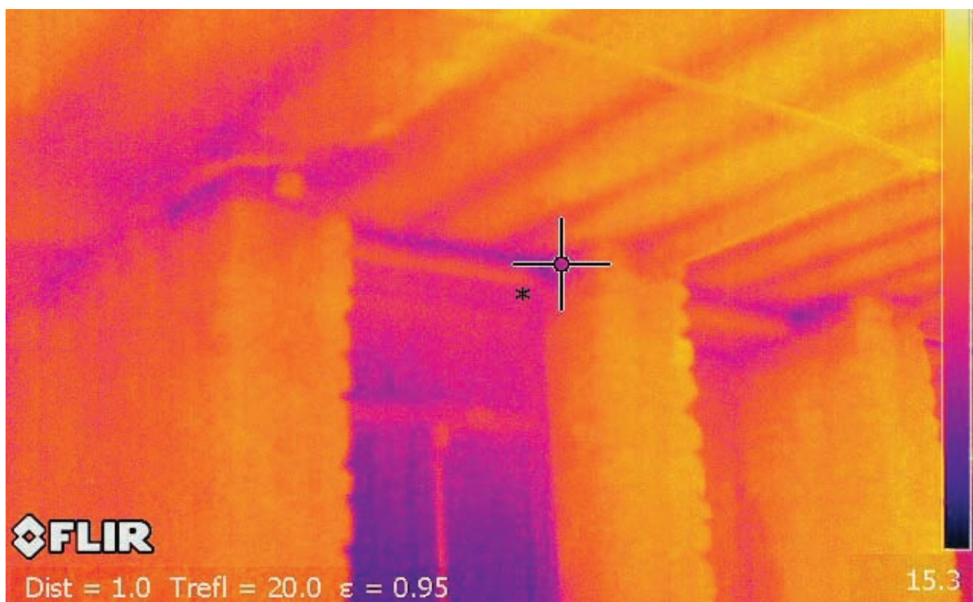
Figura 63: Scuola Elementare - Il solaio della sala mensa visto con la termocamera.
