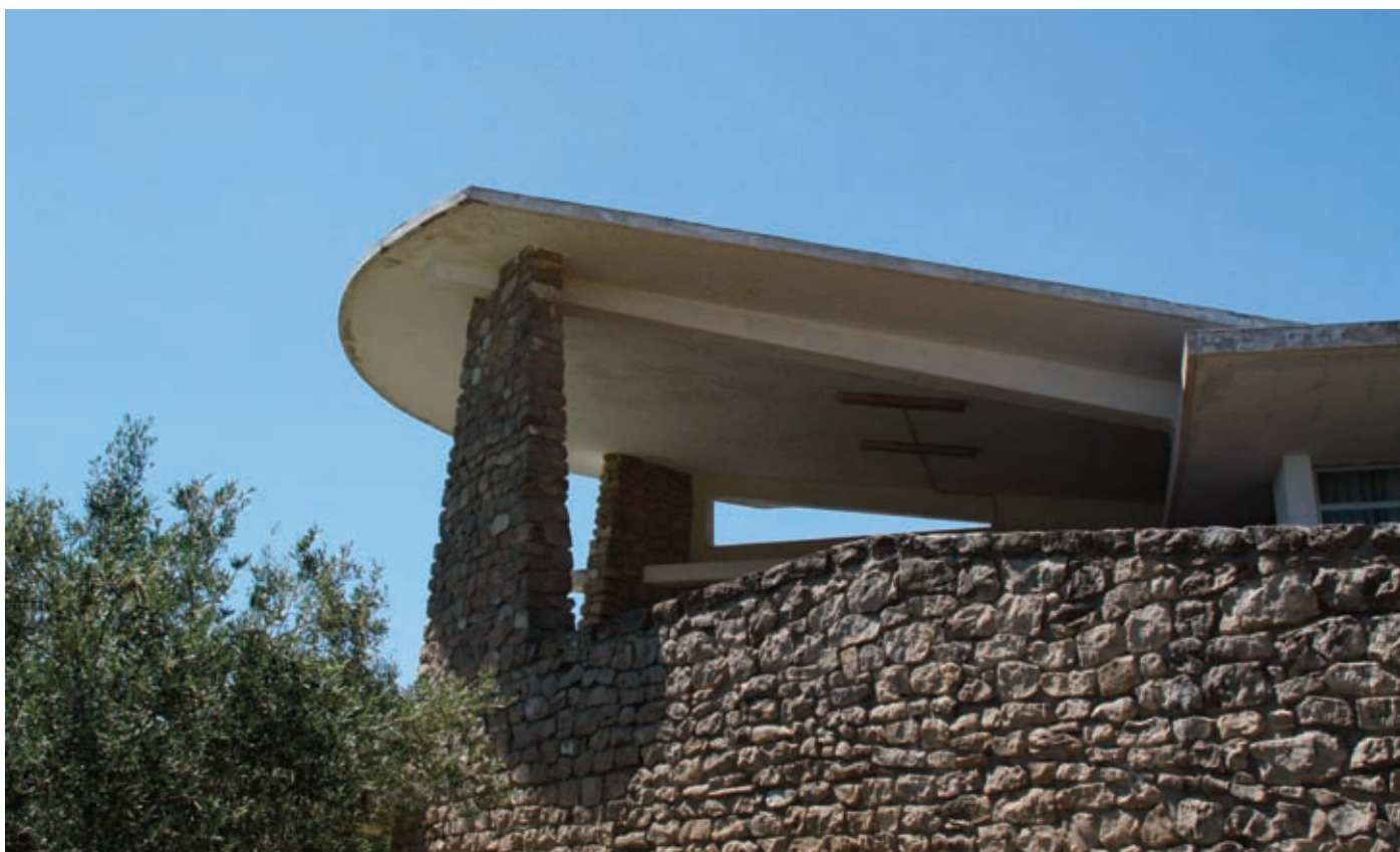
Figura 1 : Vista laterale della Scuola Materna prima dell'intervento di manutenzione straordinaria.
