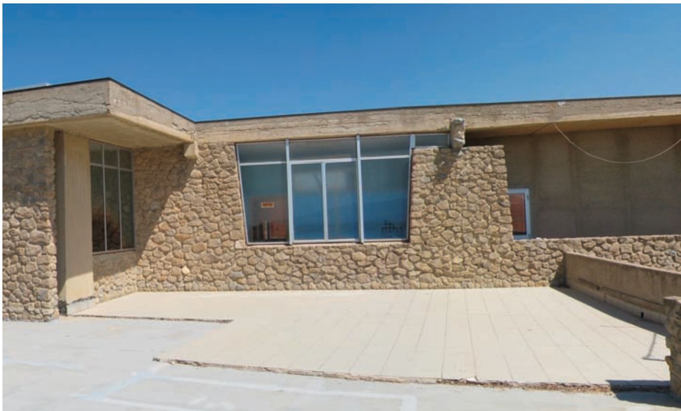
Figura 12 : La Terrazza della Scuola Elementare prima l'intervento di manutenzione straordinaria.
