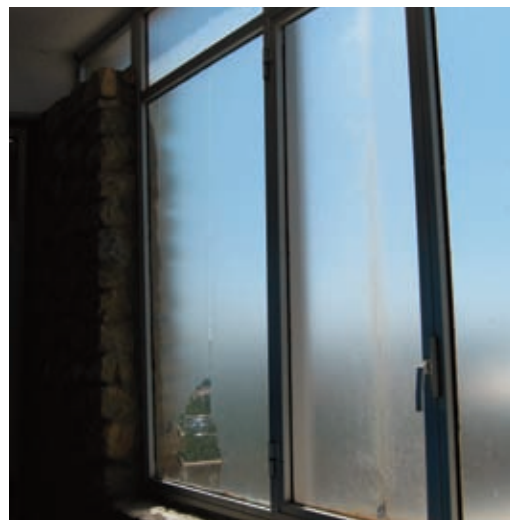
Figura 67: Scuola Elementare - Linfisso in alluminio sostituito negli anni Ottanta.
