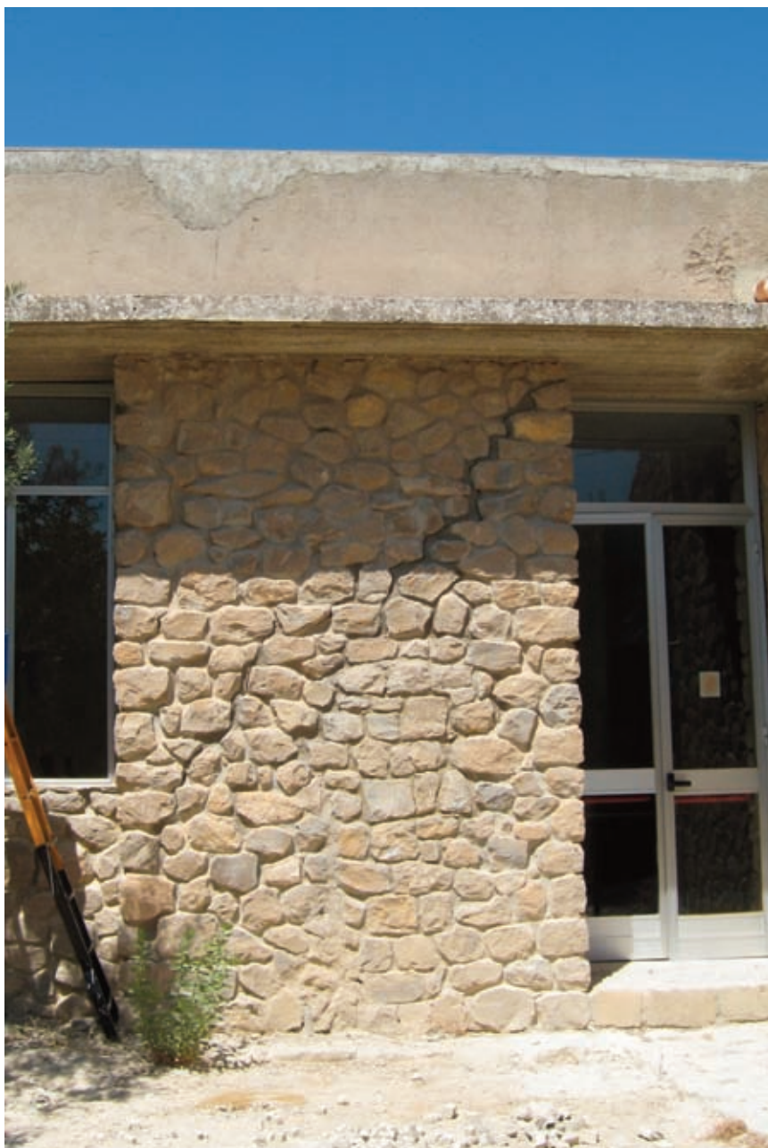
Figura 64: Scuola Elementare - La parete della sala mensa interssata dalla lesioni.
