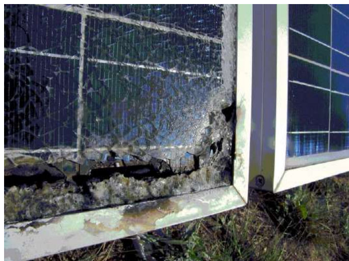
Figura 13 danneggiamento di un pannello dovuto all'arc fault
