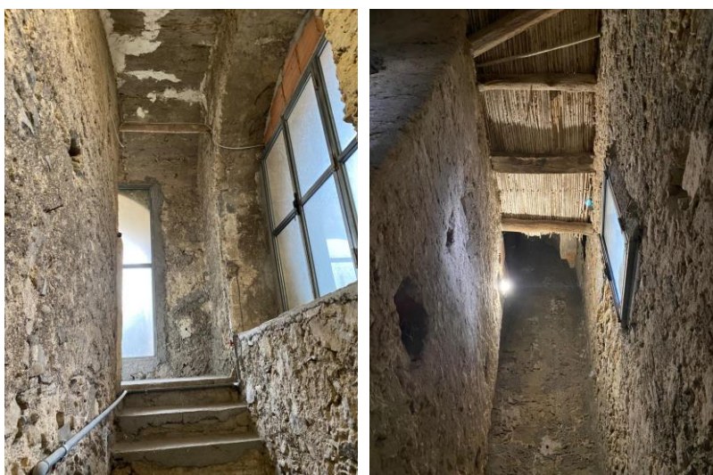
Figure 102-103. Chiesa madre di San Basilio. Spazio interstiziale fra la vecchia e la nuova torre del campanile.
