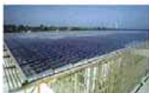
Fig. 10.16 - L'impianto fotovoltaico dell'Accademia di Mont-Cenis in Germania
