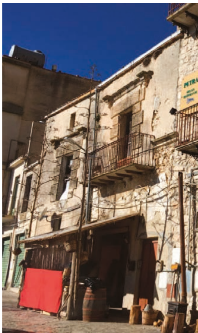
Figura 8. Caltabellotta, edificio del centro storico con cornici bugnate; nella pagina accanto il particolare della cornice.
