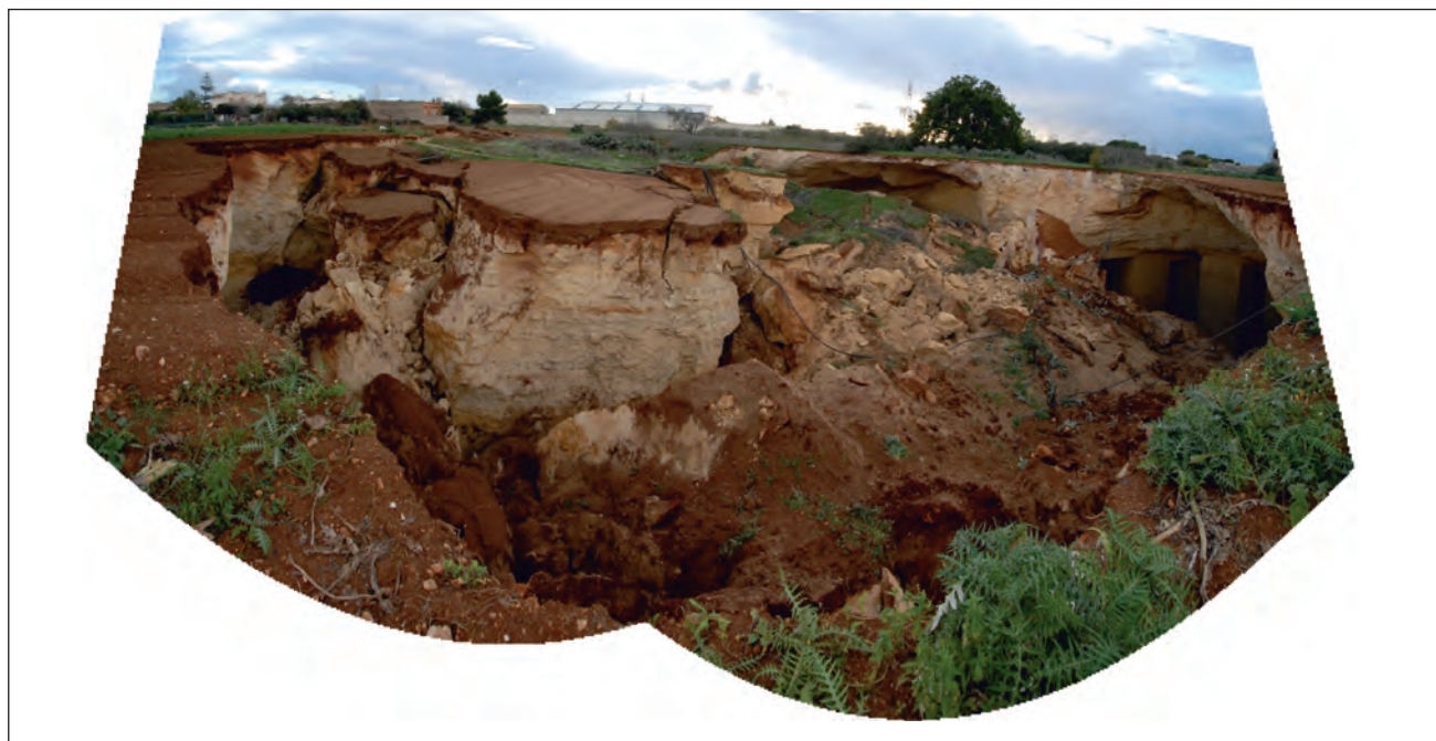
Fig. 3 - Panoramica dell'area interessata dallo sprofondamento, ripresa da Est. Sulla destra sono ben visibili le camere ed i pilastri della cava sotterranea, mentre sulla sinistra si apprezzano grossi pilastri di roccia basculati rispetto alla loro posizione originaria.
