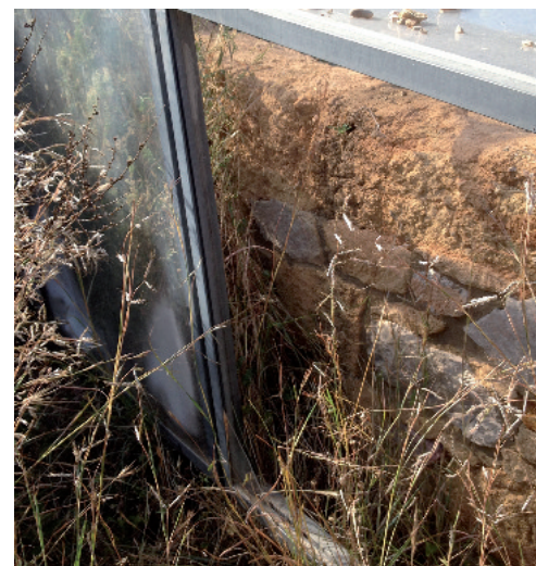
Fig. 10 - Solunto, muratura con uso di terra cruda protetta con una struttura di ferro e vetro: i danni sono evidenti.
