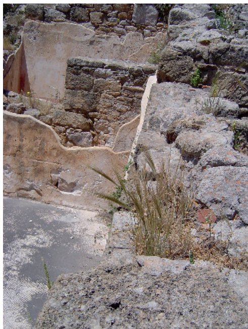
Fig. 6 - Solunto, Casa di Leda, particolare dello stato di conservazione delle creste dei muri invasi da vegetazione.
