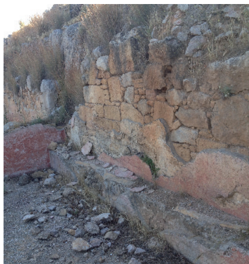
Fig. 9 - Solunto, ambiente dell'Agorà, lato ovest: degradi e dissesti causati da errati interventi di restauro degli strati di intonaco e da mancanza di manutenzione.
